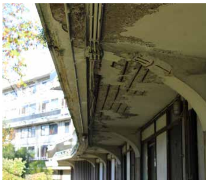
Betonherstel aan de buitengevel is een zichtbare prioriteit.
